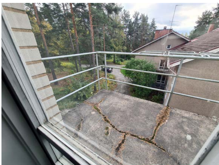
Kuva: 122. Kuvassa talon eteläpäädyn tuuletusparveke. Parvekkeen kaiteet ovat olleet sirorakenteista, maalaattua teräsputkea.
